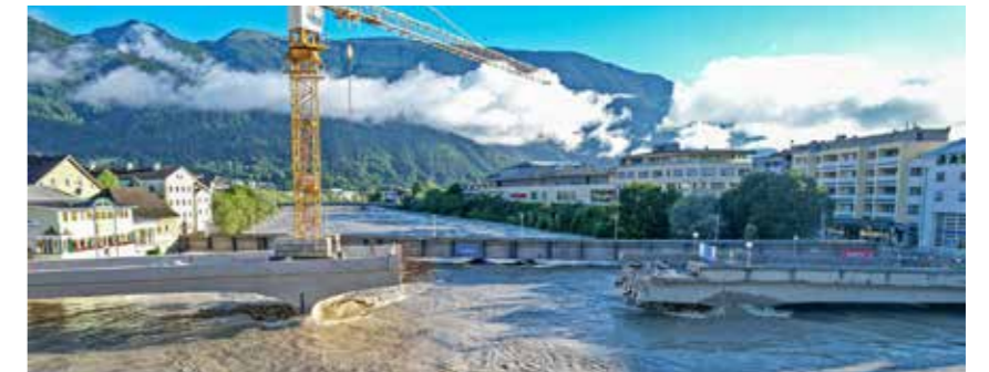
Gut zu erkennen ist die verbesserte Durchflusshöhe beim neuen Brückenteil auf der linken Seite.
