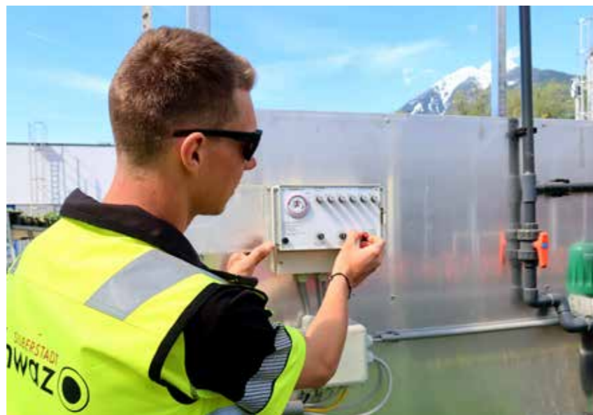
Die Steuerung der Gießanlage kann nach den Bedürfnissen der Pflanzen eingestellt werden.
